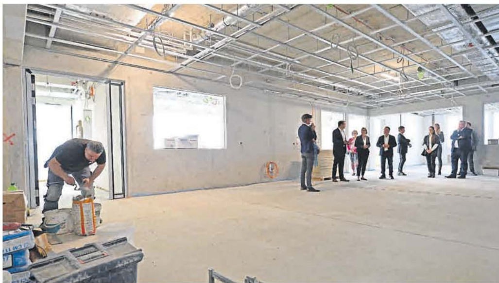
Flure im herkömmlichen Sinne gibt es im Neubau der Pfrimmtal-Realschule plus nicht. Als Verbindung zwischen den Klassensälen dienen Gemeinschaftsräume.
